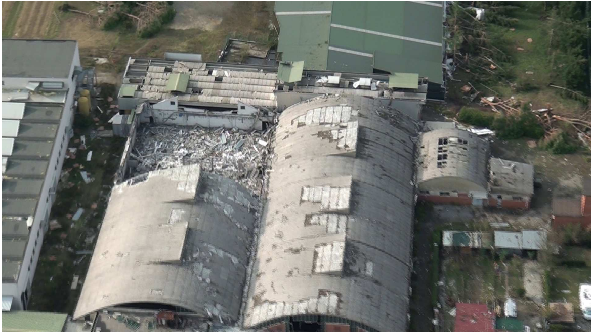
Figura 2 – Immagine da ortofoto a volo basso: particolare copertura in eternit danneggiata della manifattura
