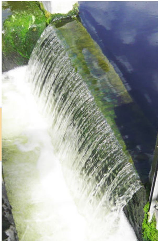
Scarico refluo depurato
