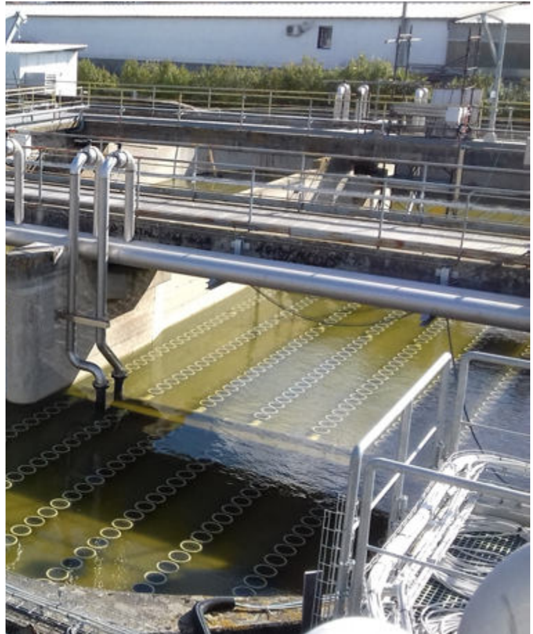
Impianto di depurazione
