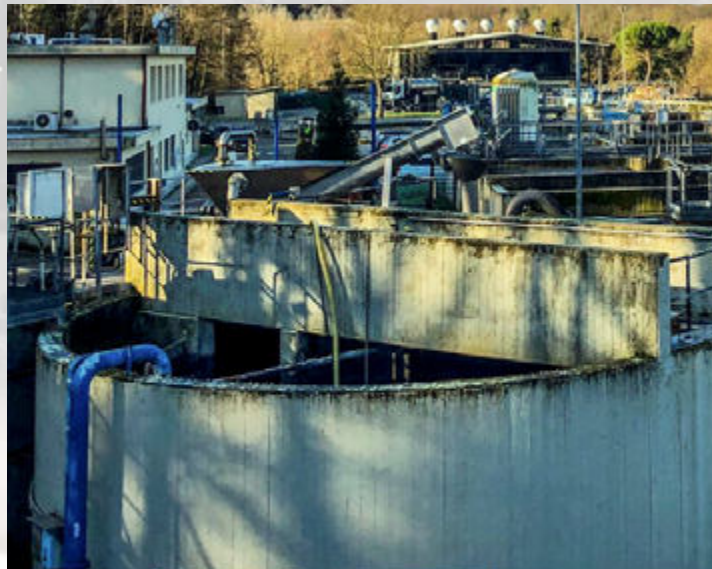
Vasche di sedimentazione
