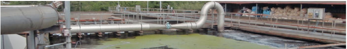
Vasche trattamenti biologici
