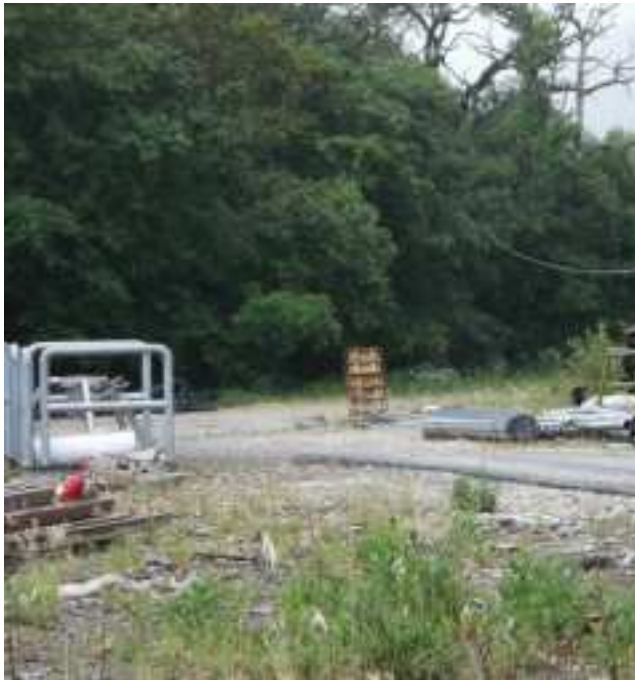
Foto 21) del 23/05/2014 attrezzature da cantiere, un estintore e qualche rifiuto di imballaggi in legno a terra
