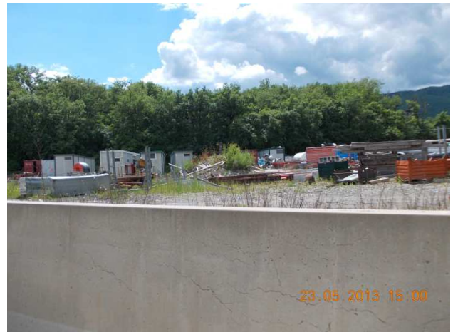
Foto 10) del 23/05/2013 il cumulo dei rifiuti da demolizione è più evidente al centro della foto
