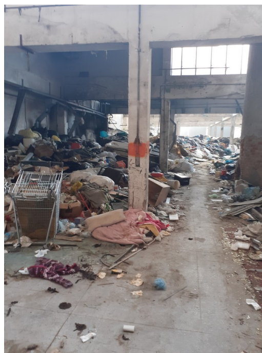
Foto 4: cumuli di rifiuti all'interno del capannone
