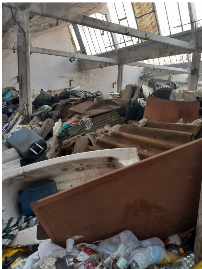
Foto 8: cumuli di rifiuti all'interno del capannone
