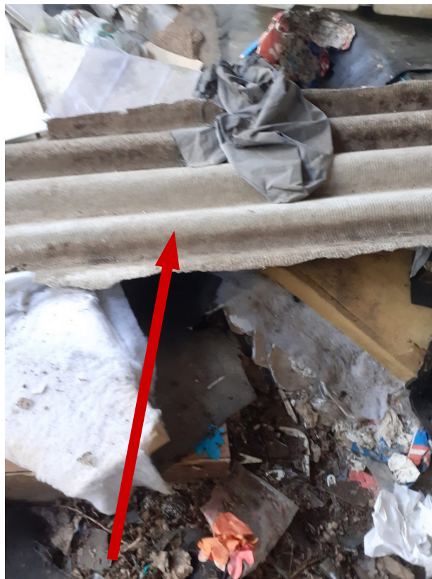
Foto 12: pezzo di copertura in fibrocemento
