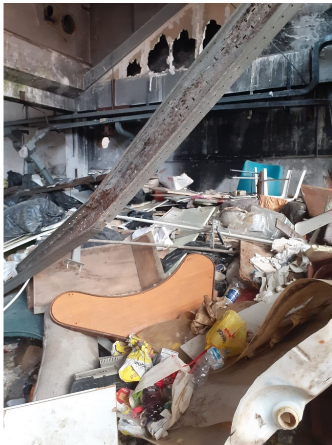
Foto 7: cumuli di rifiuti all'interno del capannone
