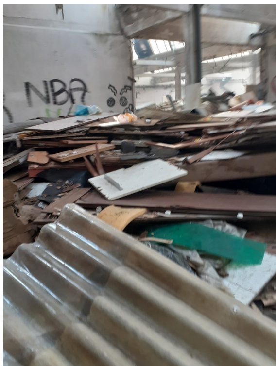
Foto 3: cumuli rifiuti all'interno del capannone
