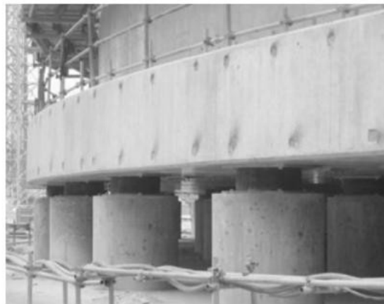
Alcuni dei 360 isolatori HDRB, di 700 mm di diametro, installati in uno dei 3 serbatoi LNG costruiti nella Provincia di Guangdong, nella Cina Meridionale (tali serbatoi hanno 84 m di diametro, 39 m d'altezza e pesano, quando pieni, 140.000 t)
