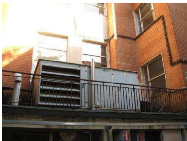
Foto 4-5: Centrale termica e Unità Trattamento Aria
